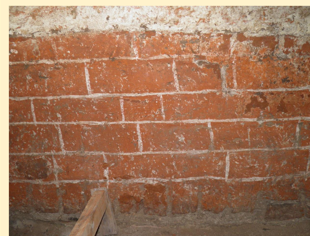
Abb.5: Ziegelmalerei (Sockelbereich/ W-Wand)
