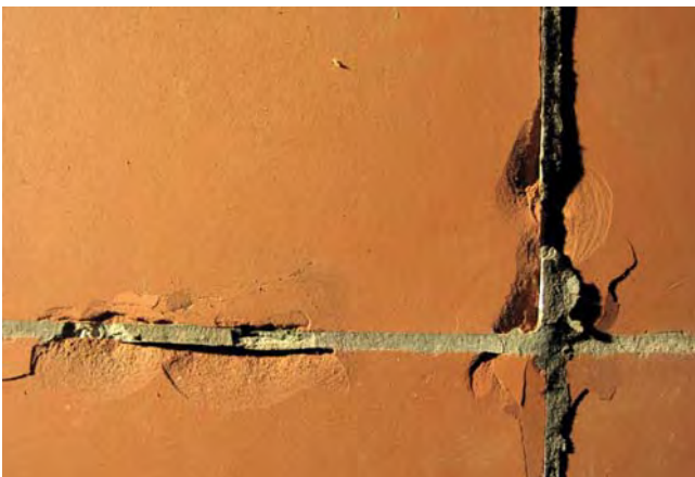
132 Detail: Rote Wandfliesen im Guftraum; Flankenabriss entlang der Fugen, Zustand 2010, Foto: Annett Baack.
