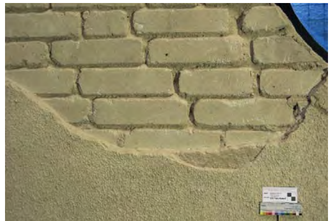
133 Detail: Fehlstelle des Edelputzes an der Westwand im Oberbau, darunter sichtbares Ziegelmauerwerk mit entfestigtem Fugenmaterial 2010, Foto: Annett Baack.
